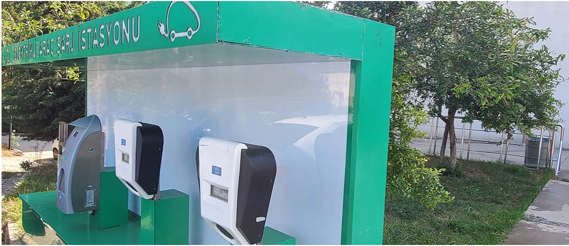
Şekil 9 Elektrikli Araç Şarj İstasyonu
